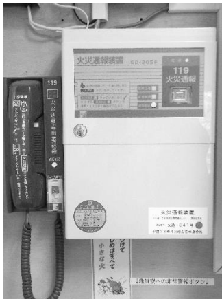
火災通報装置
